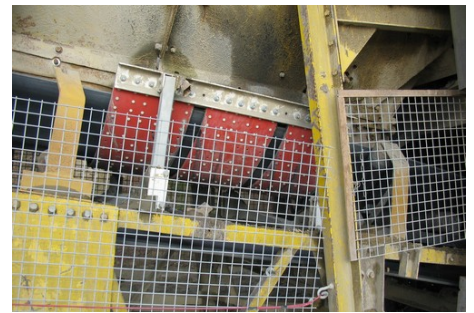
Cementerie, 600 T/h, nastro da 1000
